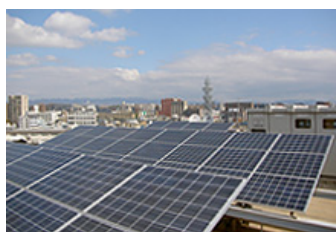
グループ会社でも再生可能エネルギーの活用に取り組んでいます(写真は西日本電気システム株式会社の太陽光発電システムの例)
